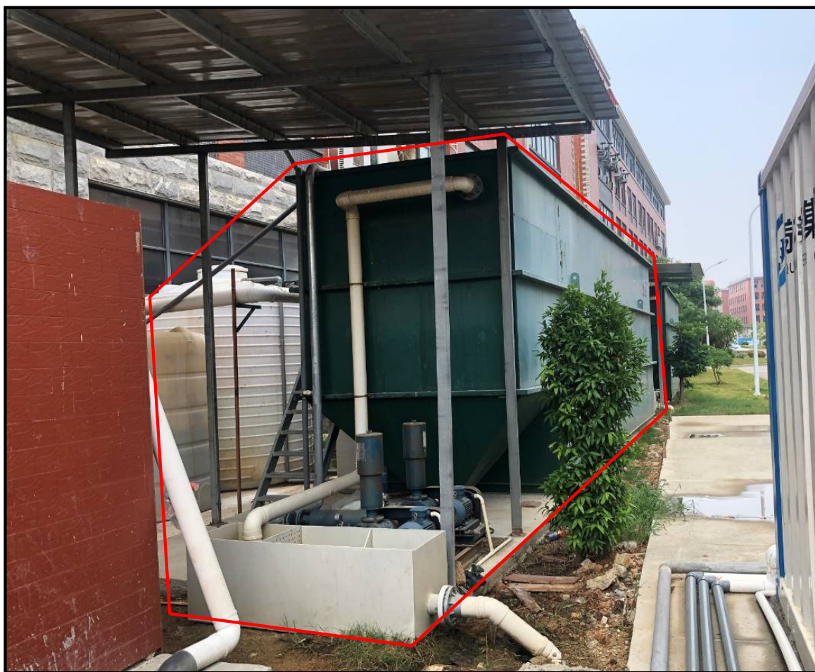
图 4.1-1 项目废水处理设施现场拍摄图
