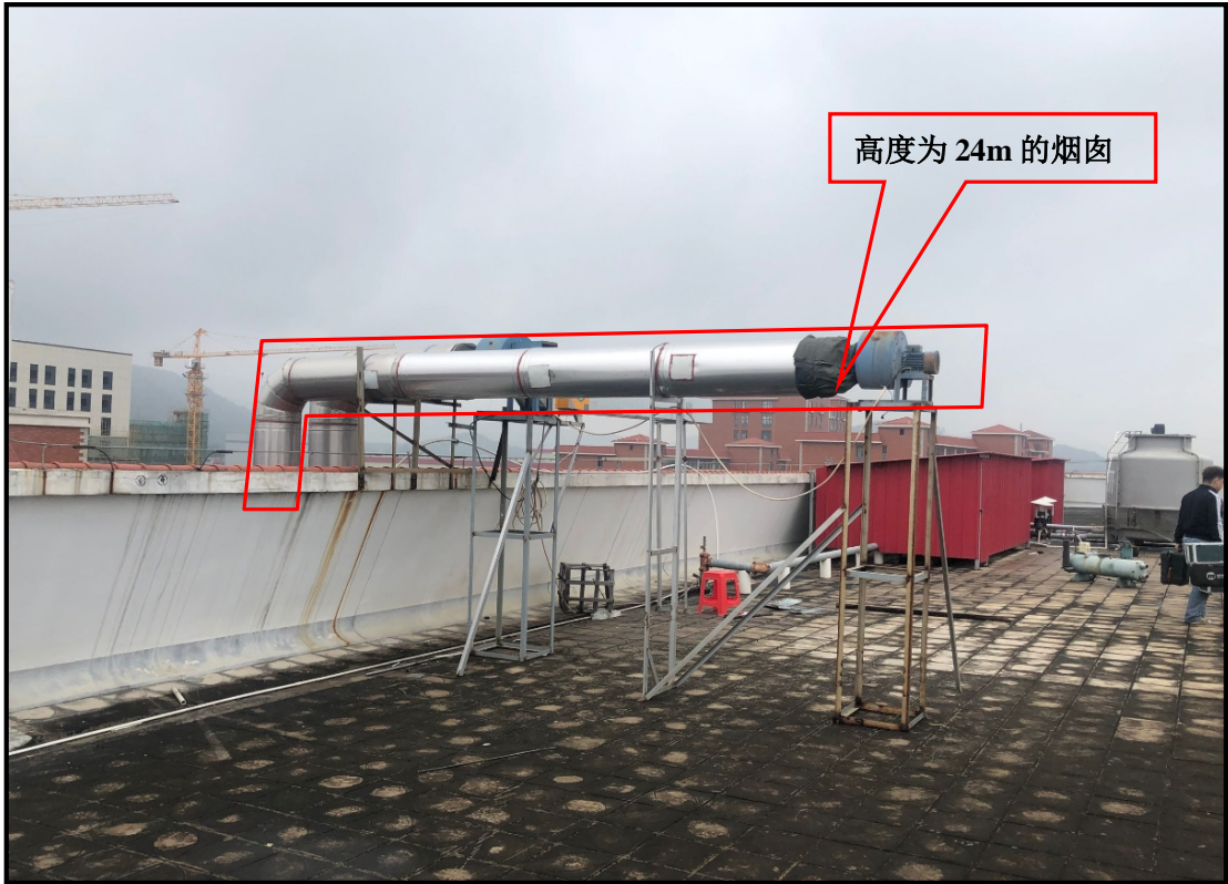
烘烤燃烧燃料废气治理设施现场拍摄图
